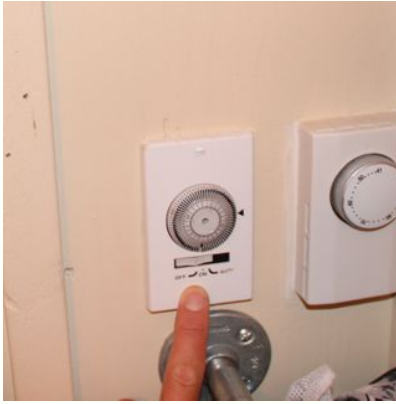
Whole house exhaust fan timer.
